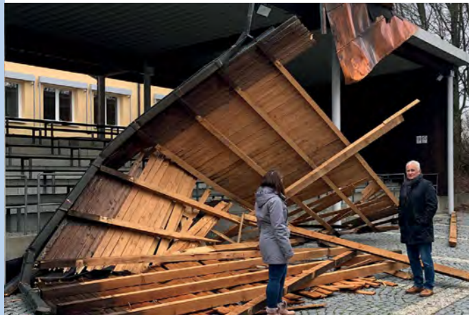
Vor dem Trümmerberg des ehem. Schuldaches stehen Anna-Lena Oberbrückner (li) und Bürgermeister Karl Obermeier (re) mit betroffener Miene
