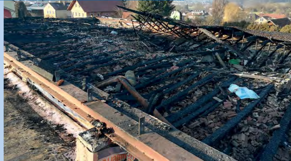
Der Brand im Dezember 2019 richtete immensen Schaden am Hallenbad an
