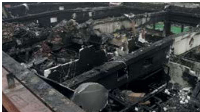
Der komplette Dachstuhl war abgebrannt und auch alles, was sich im Hallenbad befand, wurde Opfer der Flammen
