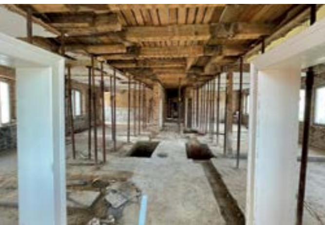
Erdgeschoss; im Bereich der geplanten Dauerausstellung zur Bauernschicht: Hier wird aktuell vollkommen entkernt und die Zwischenwände sind entfernt worden Bild: Wido Kilian
