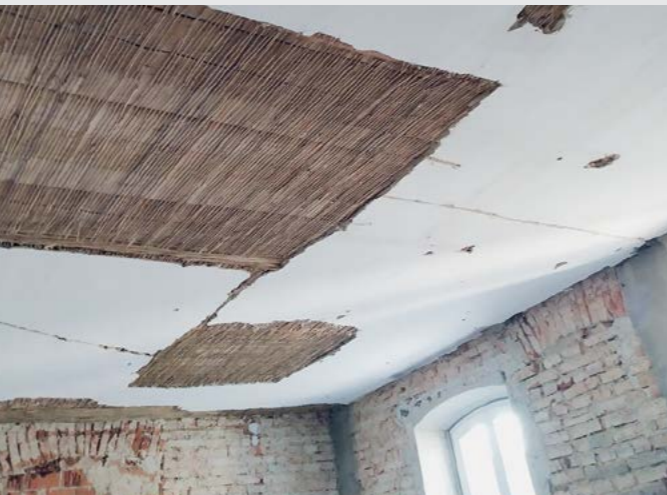
(oben) Die alte Schilfrohrbasis der Decken stellt in punkto Brandschutz eine Herausforderung dar. Sie werden entsprechend saniert, um die Feuerwiderstandsklasse F30 nach DIN 4102 zu erfüllen.
