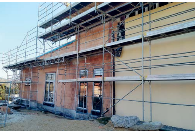
(oben) An den bestehenden Gebäudeteil wurde der Anbau bereits deutlich weitergeführt, im gesamten Saunabereich sind Fenster und Türen fertig eingebaut*
